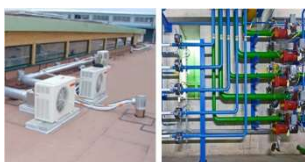
Instalacje klimatyzacji, wentylacji HVAC i wody
